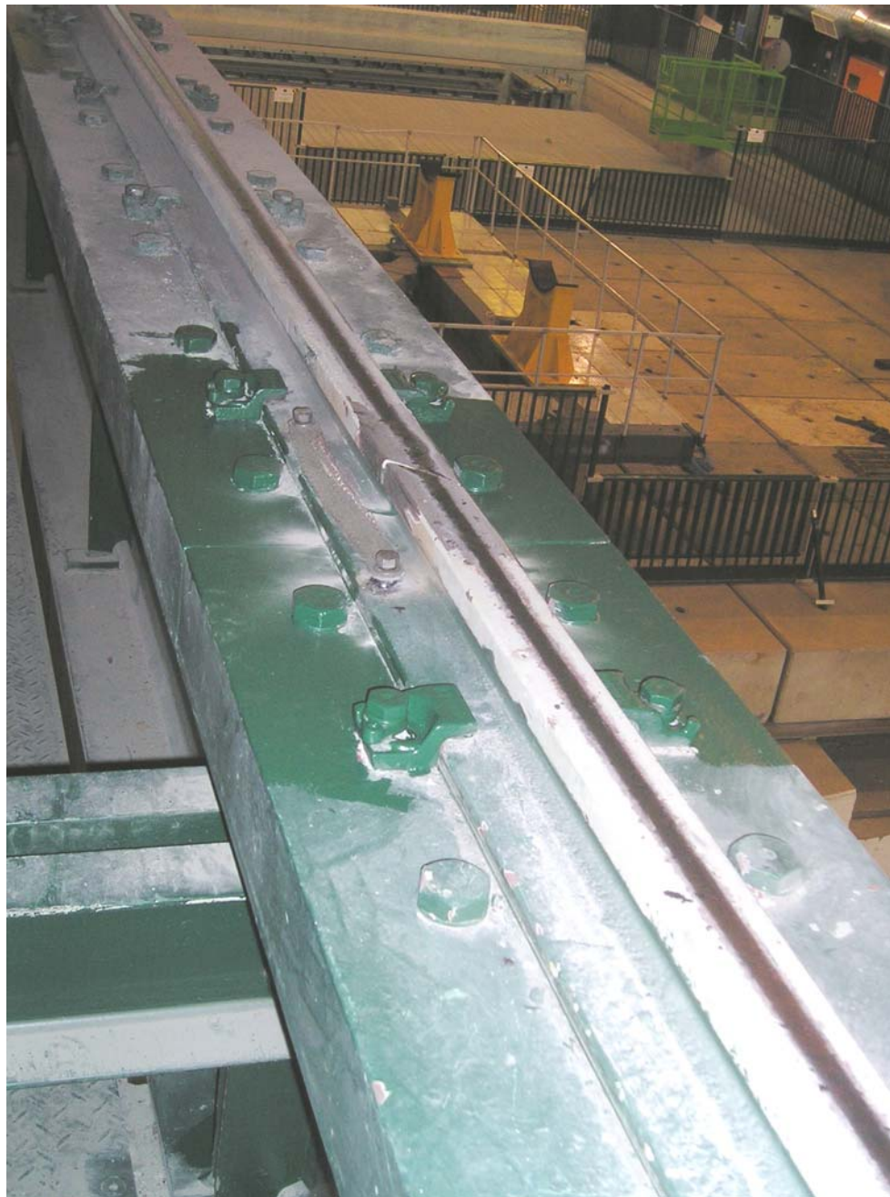
Chemin de roulement du pont-roulant 20t dans le bâtiment SX-1
